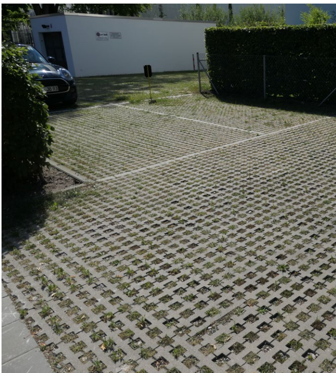
Abb. 48: Teilentsiegelung eines Parkplatzes, Freising
