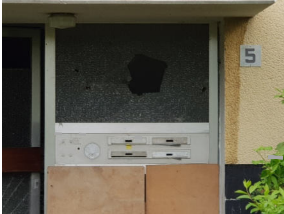
Abbildung 5: Gebäude mit Sanierungsbedarf Drosselweg
