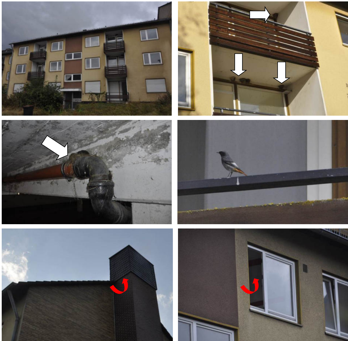
Abbildung 2: Nachweise von Mehlschwalbennestern an den Gebäudefassaden, vornehmlich im Bereich der Balkone, von einem Hausrotschwanznest in der Tiefgarage sowie von Versteckplatzern für Fledermäuse hinter Fassadenplatten und in leerstehenden Wohnungen über offene oder gekippte Fenster
